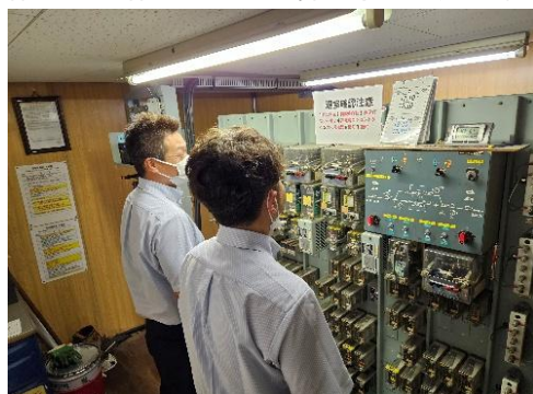
郡上八幡・郡上大和駅 制御盤等の取扱い確認
